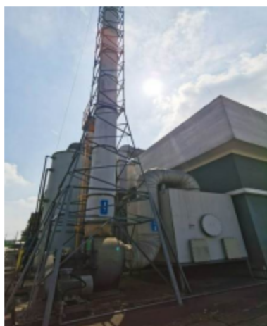
103 车间废气处理设施
