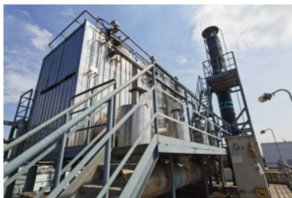
205、206 车间废气处理设施
