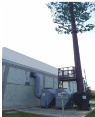
新危废间废气处理设施
