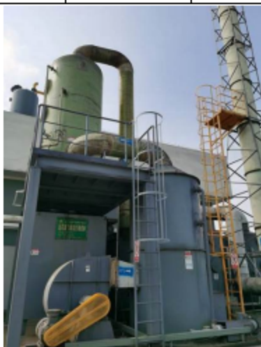
101 车间废气处理设施
