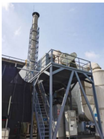
102 车间废气处理设施
